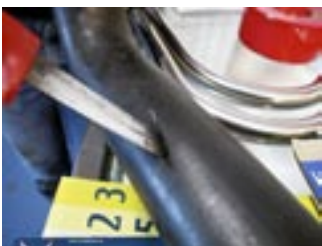
Den av remskivan sönderskavda grova kylslangen.
