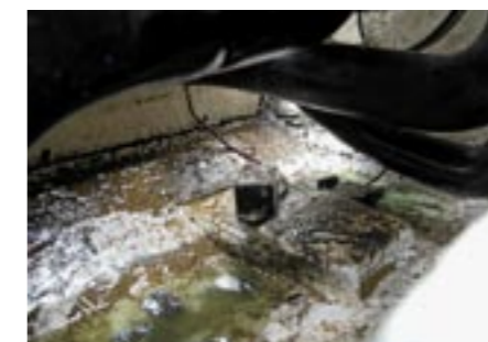
Fotot visar den plats som länsumpen stod monterad på. Ovanför ser man den grova slangen och även remskivan skyftar i överkant på bilden.
