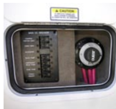
Den felkopplade batterifrånsljaren.
