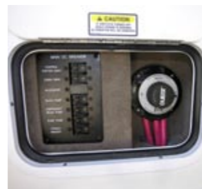
Den felkopplade batterifrånsljaren.
