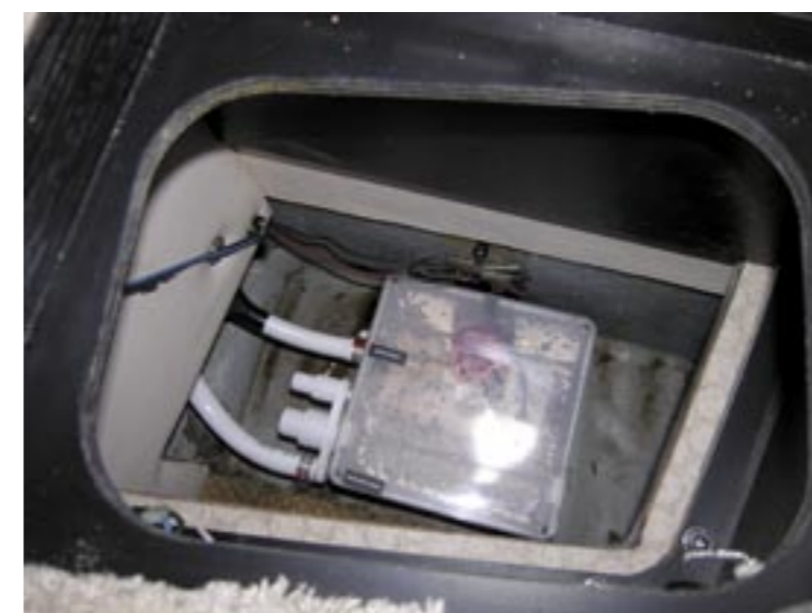
Grävattenpumpen från dusch och disk, men notera den övre vita slangen för diskvatten som övergår i svart.
