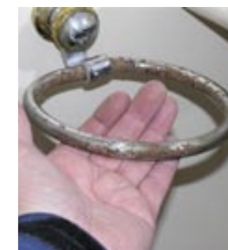
Rost och vattenskador på inredningen.
