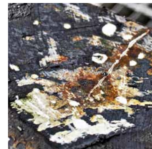
Närbild på en av sprickorna, och omöjliga att upptäcka utan insikt i problemet.
