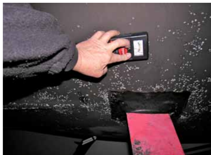
Partiell fukt som ett resultat av obefintligt skydd mot vatteninträning under många år.
