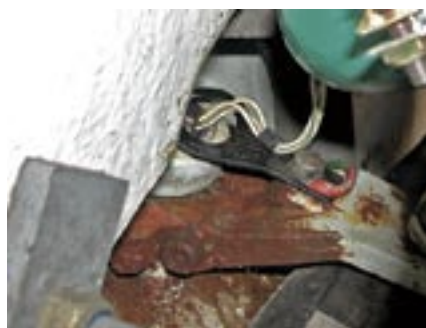
I mörkret har kameran hittat ett kraftigt rostangrepp invändigt på drevet.
