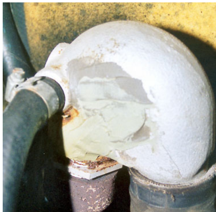
Avgaskrökar gjutna i stål gjutgods rostar sönder. Dylka reparationer är inte att rekommendera, idag är utförandet i brons och håller i evigheter.
